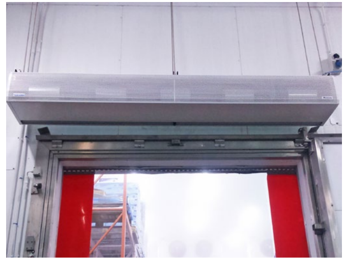
Kool Instal·lació en una fàbrica d'aliments i begudes
