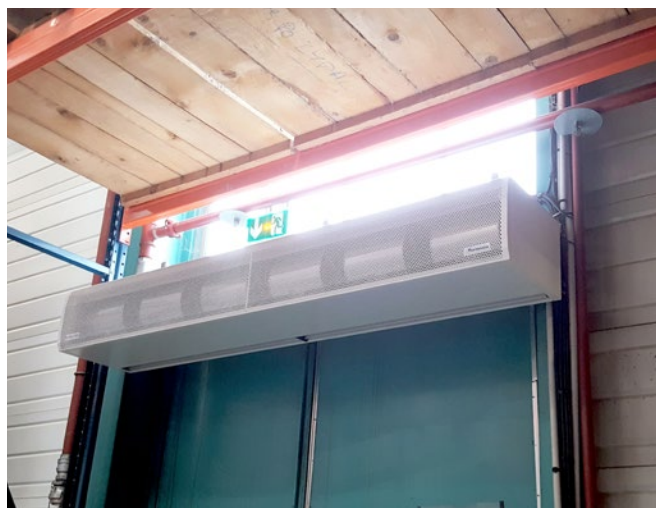
Fly KBB Instal·lació en l'entrada d'una fàbrica d'embalatges
