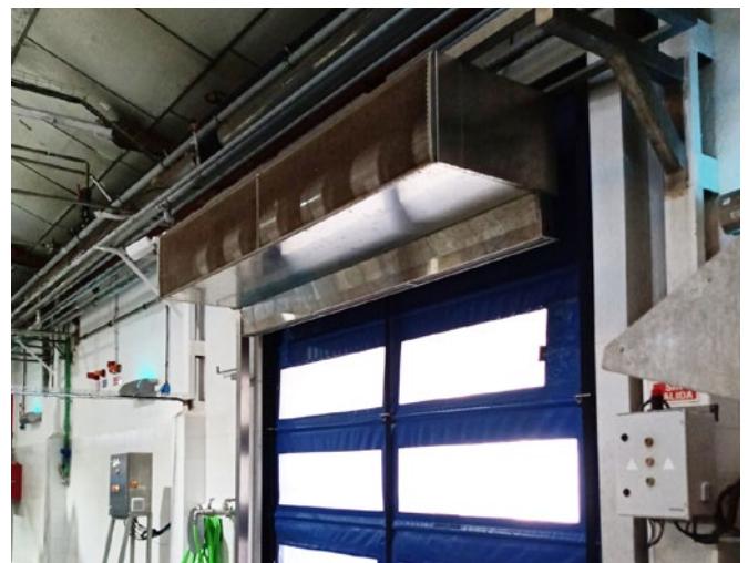
Fly KXL Instal·lació en una fàbrica d'anxoves i sardines
