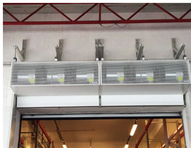
Fly KXL Instal·lació en una fàbrica de productes làctics
