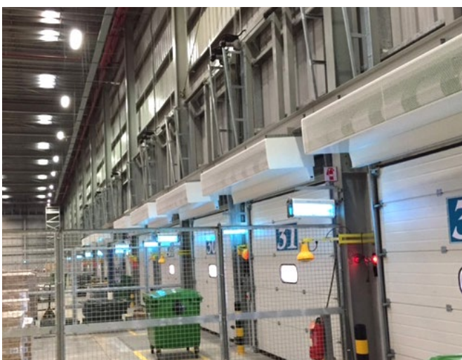
Fly KXL Instal·lació múltiple en una fàbrica de cosmètics i sabons
